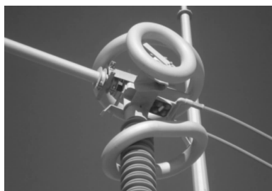
图1 断裂的隔离开关均压环
